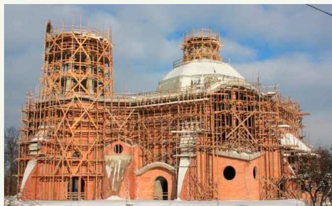
Rok 2010 zakończył się wykonaniem całej konstrukcji ↑ żelbetowej, ścian budynku, kopuły. Całość nakryto płytą. Stan surowy, ale jeszcze bez dachu, wykonany.
