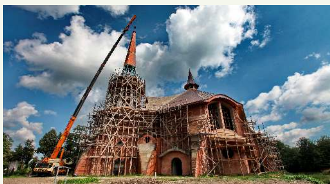
↑ W tym roku z wiosną ruszyła również budowa 18 metrowej metalowej części wieży zwieńczającej kościół, która została zamontowana w sierpniu
